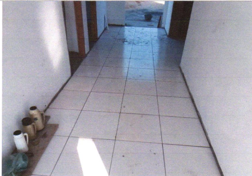
Foto 01 - REVESTIMENTO CERÂMICO PARA PISO COM PLACAS TIPO ESMALTADA EXTRA DE DIMENSÕES 45X45 CM APLICADA EM AMBIENTES DE ÁREA MAIOR QUE 10 M2. AF_06/2014
